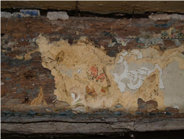
5. loftsbjælke med tapetrester mod gl. stue
