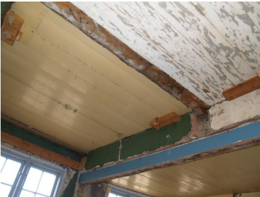
6. fag set mod vest viser det hævede loft og spor efter væg i loft. Bemærk spor efter el-installation. På undersiden af loftsbjælke anes huller til støjler og en oversavet stolpetap dér, hvor der har været langsgående væg.
