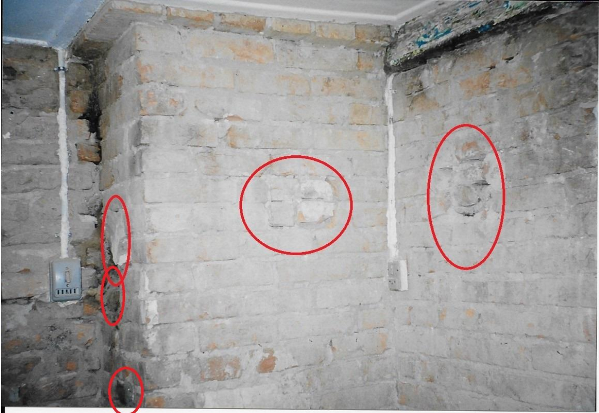
Skorsten i køkken med tilmurede huller til skorstensrør markeret i væg til mellemgang og i skorsten. Det nederste hul t.v. i skorsten ses ikke.
