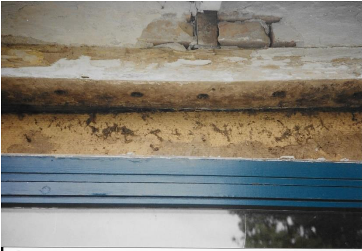
Huller til støjler i lejde over badeværelsevindue
